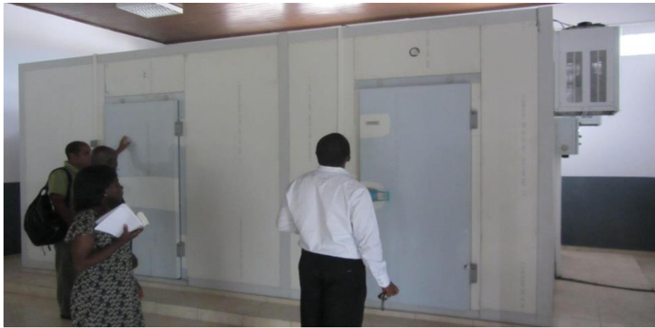
Camara de presión negativa PAV, Malabo
